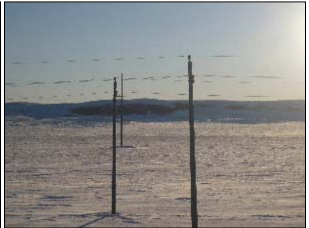
Фото 14. Станция Екаша. ЛЭП
