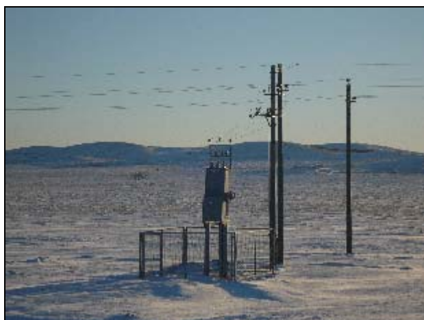
Фото 30. Разъезд Бурсак. Щит электропередачи
