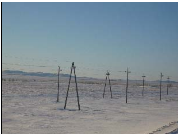
Фото 15. Станция Завидное. ЛЭП
