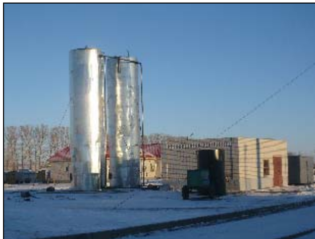
Фото 22. Ст. Шалабай. Противопожарные резервуары и насосная станция
